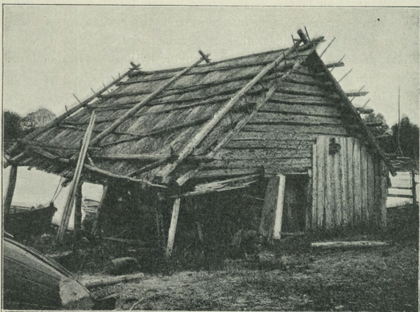
Fig. 30. Sjöbod af B-typ, med en dörr och utan svale. Grisslehamn, Vaddö sn, Uppland.
